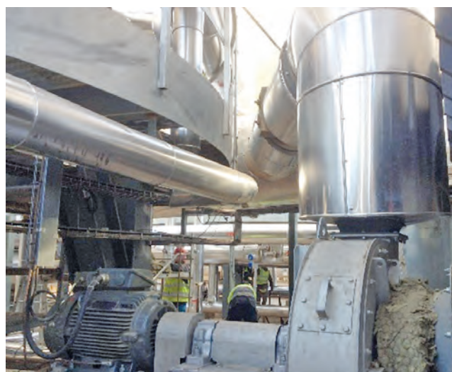
Up · Gas Recirculation Fan
